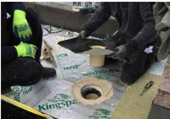
Im Bereich von Dachdurchdringungen, etwa für Gullys, wurden Ausgleichsplatten statt Vakuumdämmplatten verlegt
