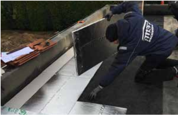
Als Grunddämmung wurden die Vakuumdämmplatten „Optim-R“ verlegt, die einen hohen Dämmwert bei geringer Dicke bieten
